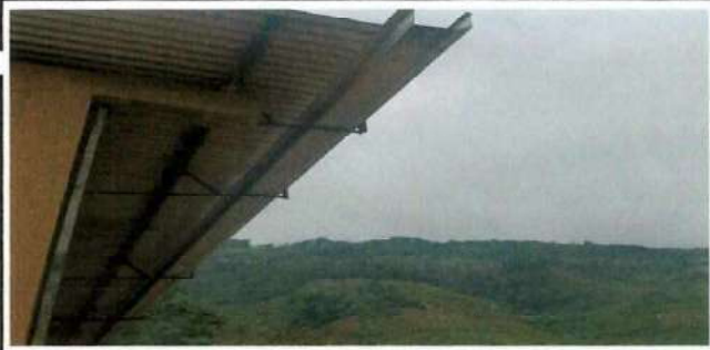
Foto 4: Se observa que las bajadas de agua ya no son funcionales y es necesario sustituir algunos canales deteriorados con el pasar de los años.
