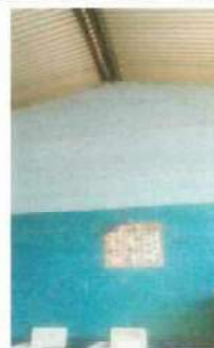
Foto 9: Se necesita pintura para las aulas que se encuentran sucias y deterioradas.
