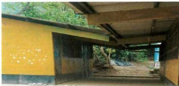
Foto 3: Se observa que las bajadas de agua ya no son funcionales y es necesario sustituir algunos canales deteriorados con el pasar de los años.
