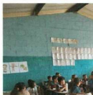
Foto 10: Se necesita pintura para las aulas que se encuentran sucias y deterioradas.
