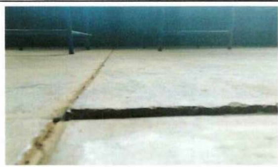
Foto 2: piso de las aulas que se encuentran en mal estado ya que se fue arruinando con el pasar de los años.
