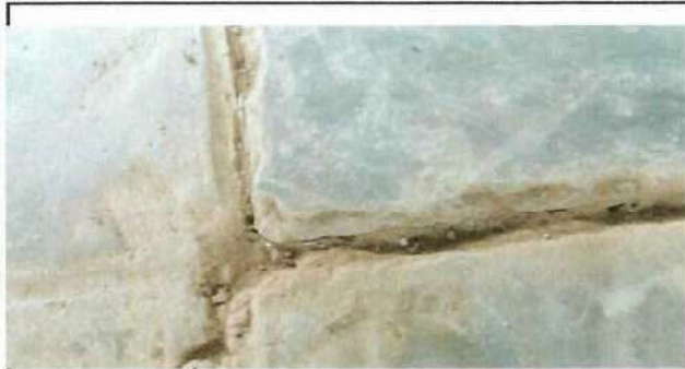
Foto 1 : piso de las aulas que se encuentran en mal estado ya que se fue arruinando con el pasar de los años.
